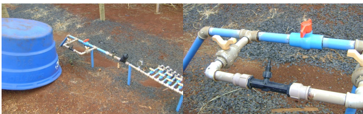
Figura 10. Malha hidráulica do sistema de irrigação por gotejamento subsuperficial.
